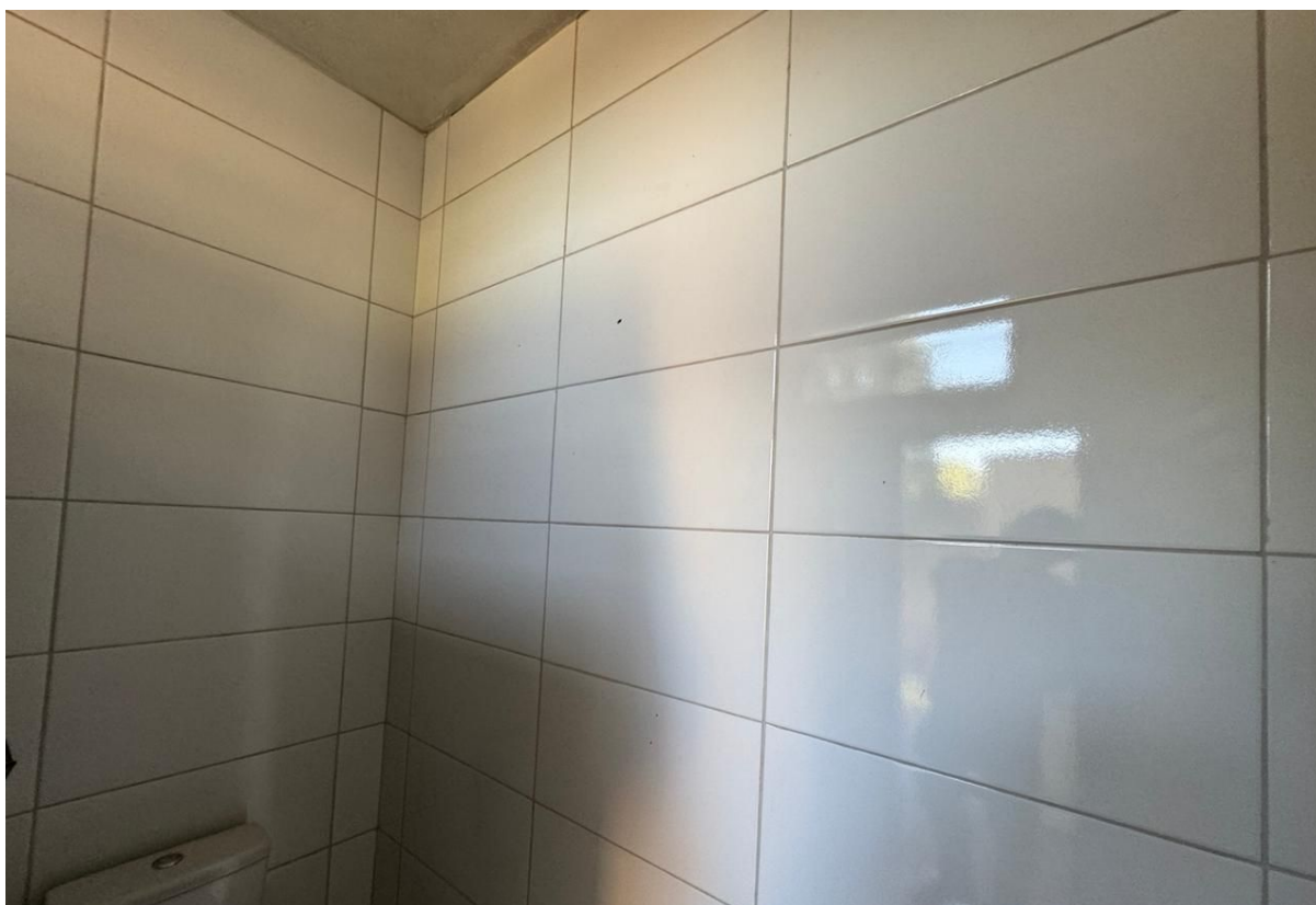
Foto 11 – Sanitário feminino – revestimento
